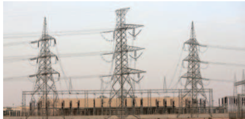
محطة سدبر لتحويل الكهرباء
